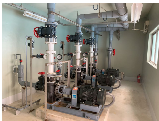
図 2-48 センター内の取水ポンプ
