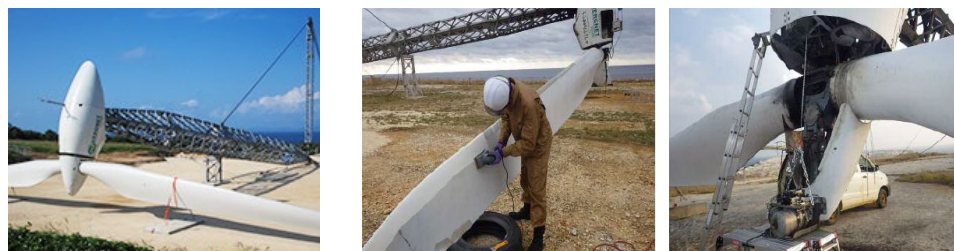
図 2-6 可倒式風力発電機と傾倒メンテナンスの様子
