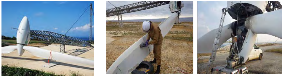
図 13 可倒式風力発電機と傾倒メンテナンスの様子
