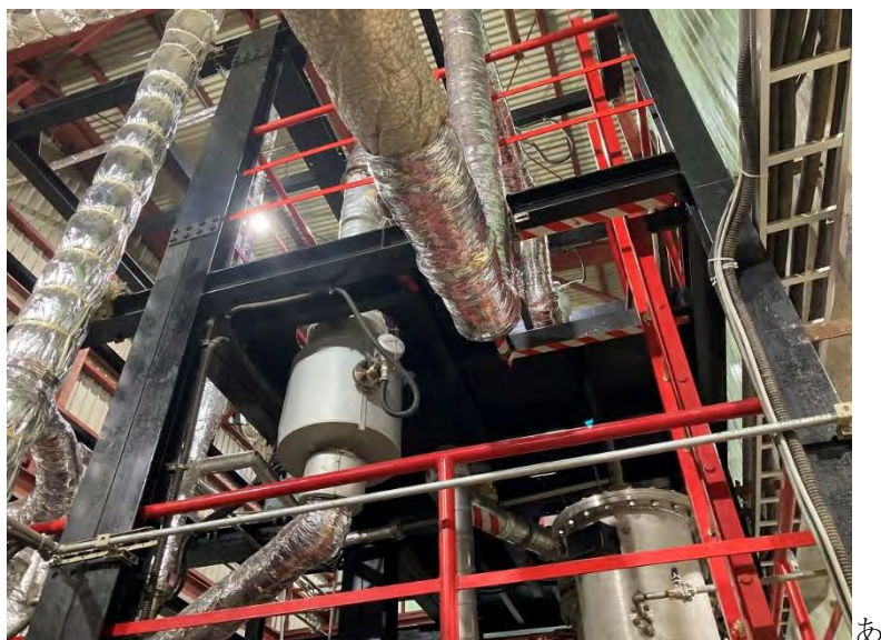
図 3-2：油化施設設備
