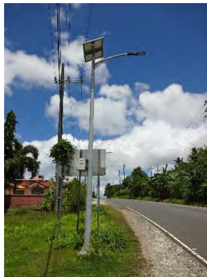
図 4-5：コロール州における太陽光発電独立型 LED 街灯
