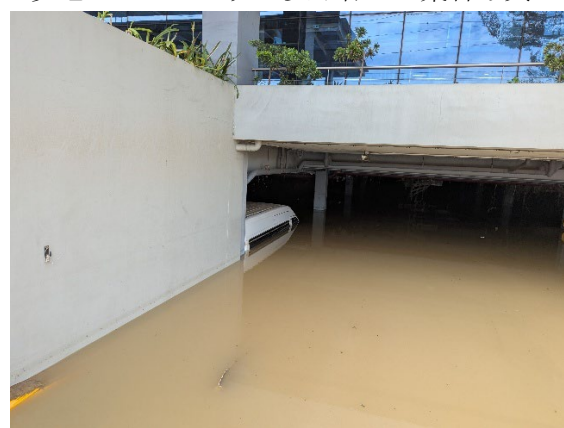
台風25号 (Kalmaegi) の影響で 浸水した駐車場
