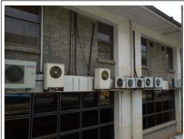
マレーシア工科大学内のエアコンの設置状況 (現地調査時に撮影)
