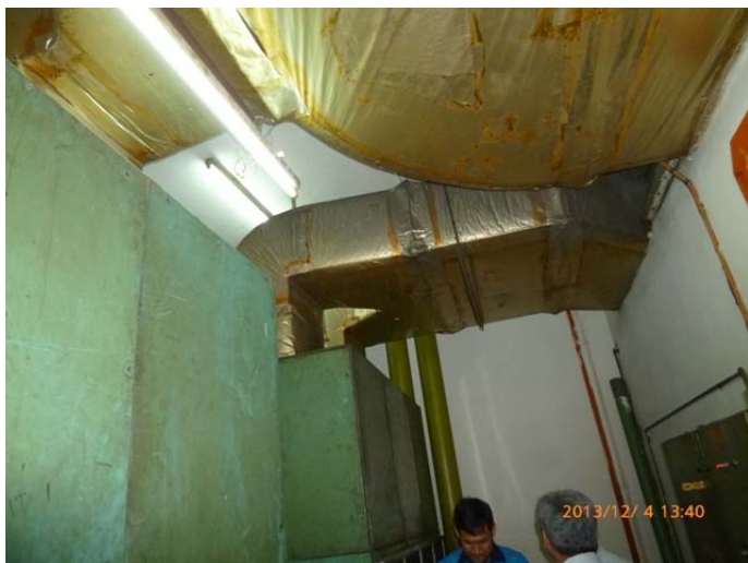
写真 3-3-9 空冷パッケージサプライダクト 風量調整用のダンパーがない
