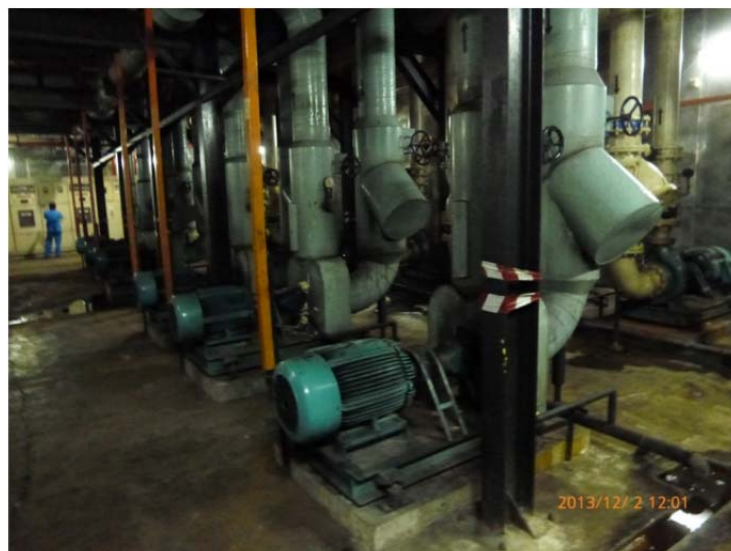
写真 3-3-14 省エネ制御していない 冷水ポンプ
