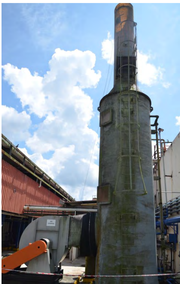
写真 4-14 (3) Ammonia stripper によるアンモニア除去
