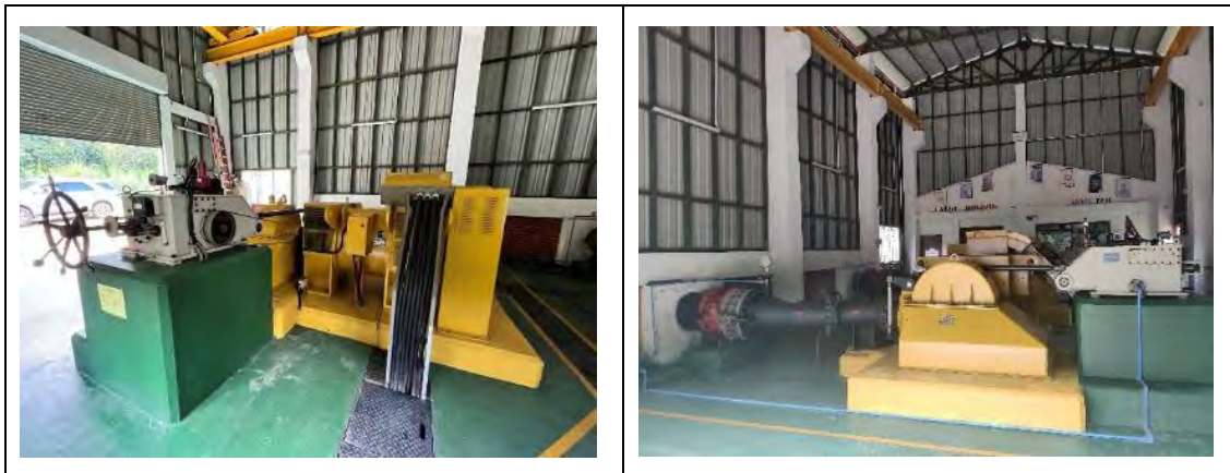
図 4-14 Naradau 発電所建屋の様子（タービン及び発電機）
