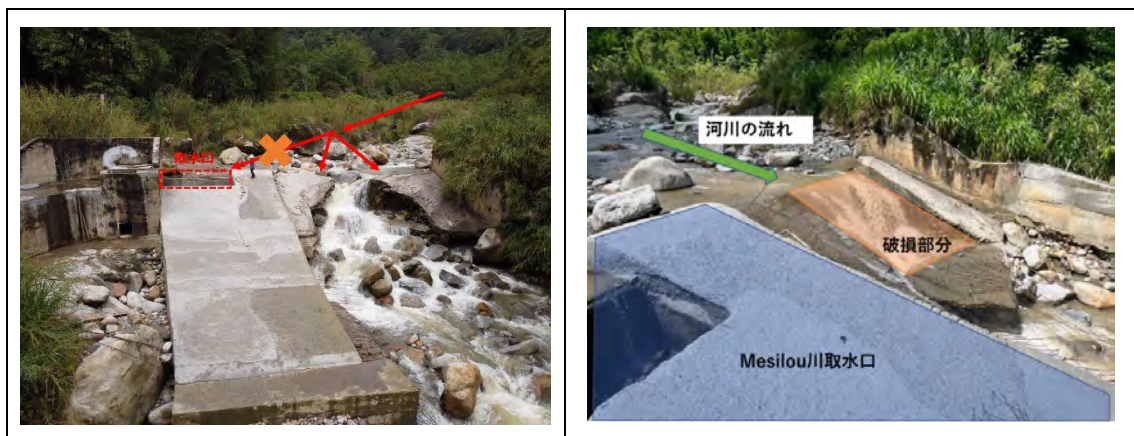
図 4-11 Mesilou 川取水口の損壊の様子
