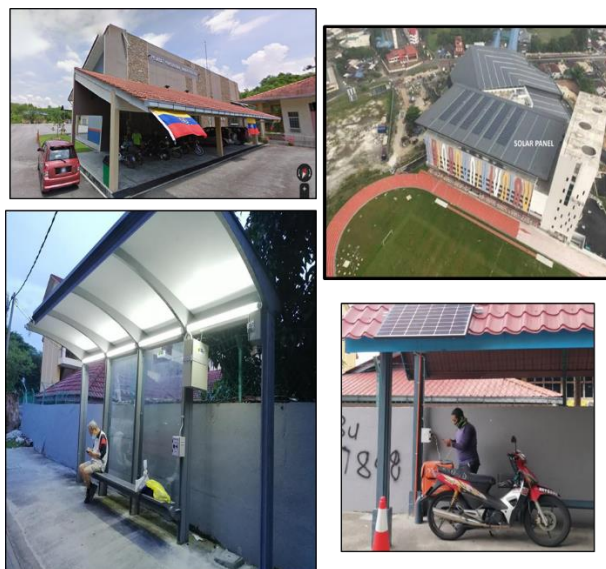
図 11: 太陽光発電設備の敷設例
