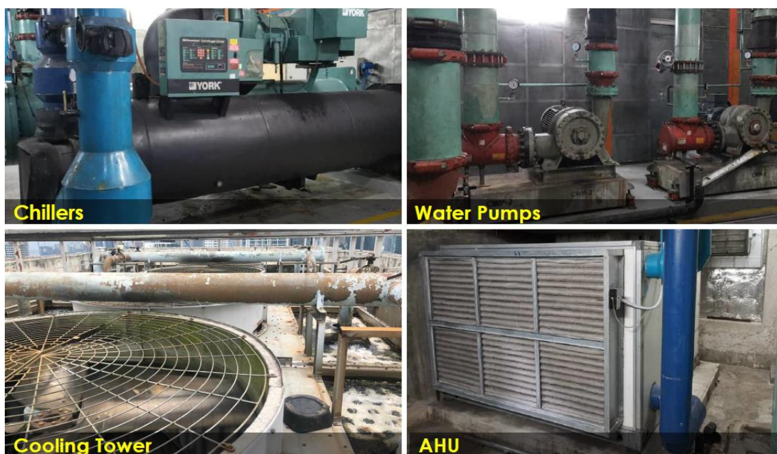
図 10: 更改予定の設備機器
