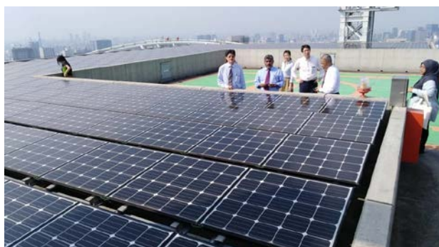
図11: 仙谷山森タワーの太陽光発電設備
