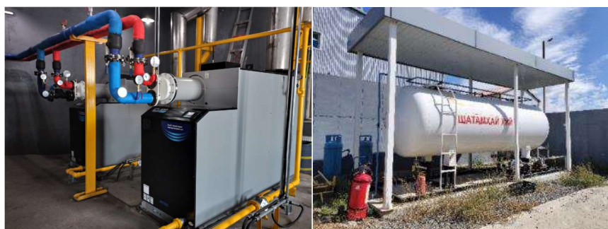
導入された LPG ボイラー設備
