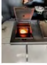
既存の石炭ボイラー (コンビニ食品工場)
