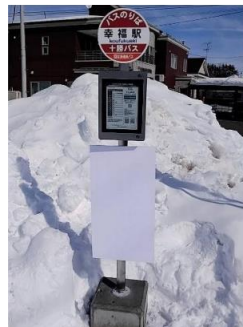
図 4-17 寒冷地でのスマートバス停の設置状況
