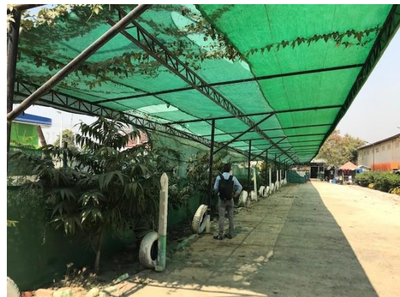
(f) ホテル駐車場架台
