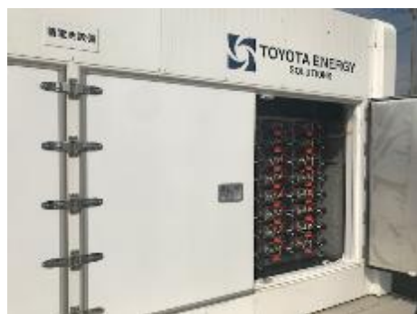
リユースバッテリーシステム
