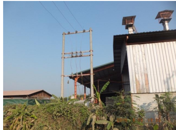
グリッドからの精米所への電力の引込線
