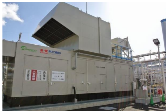
川重冷熱工業製ガスタービン
