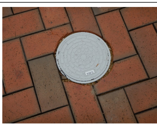
水素漏洩センサー（開封厳禁）
