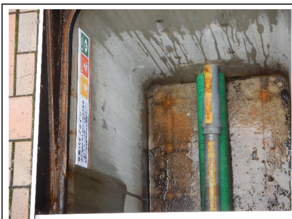
水素輸送配管
