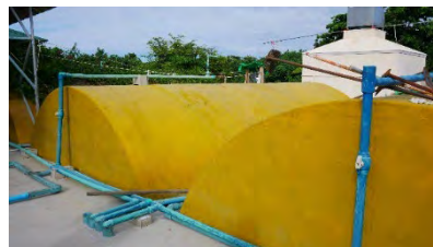
メタン発酵設備
