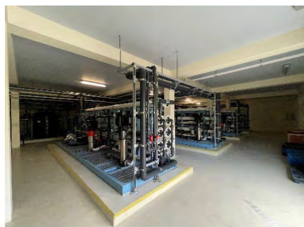
海水淡水化装置 (RO)
