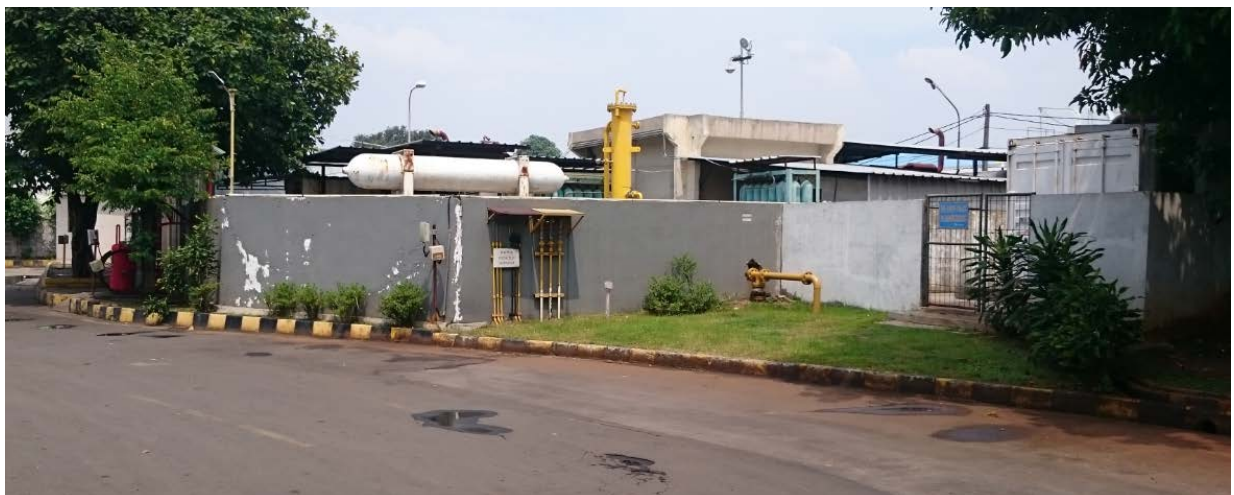
天然ガスパイプラインの引き込み・圧縮機
