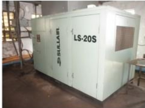
レトロフィットされたSULLAIR LS-20S 負荷変動に対応していない。 圧力の設定と応答性に問題がある。 計測診断では負荷率80%ほどで推移。
