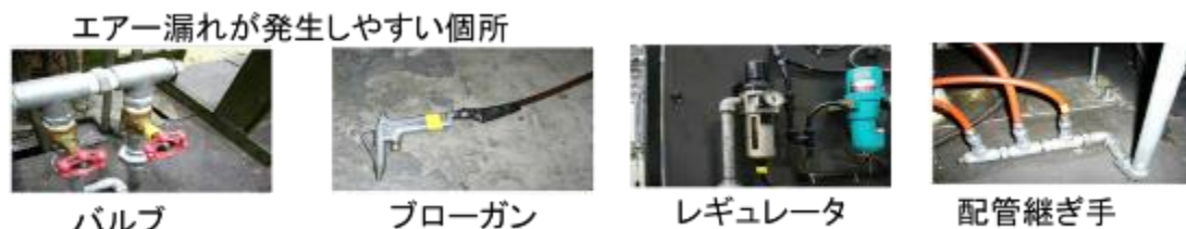
図 2-10 エアールールが発生しやすい箇所の一例
