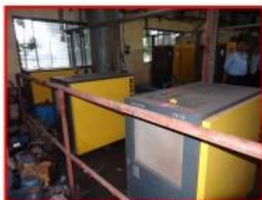
排気ダクトが無く室内に排気しているため 暖かい空気を吸気している
