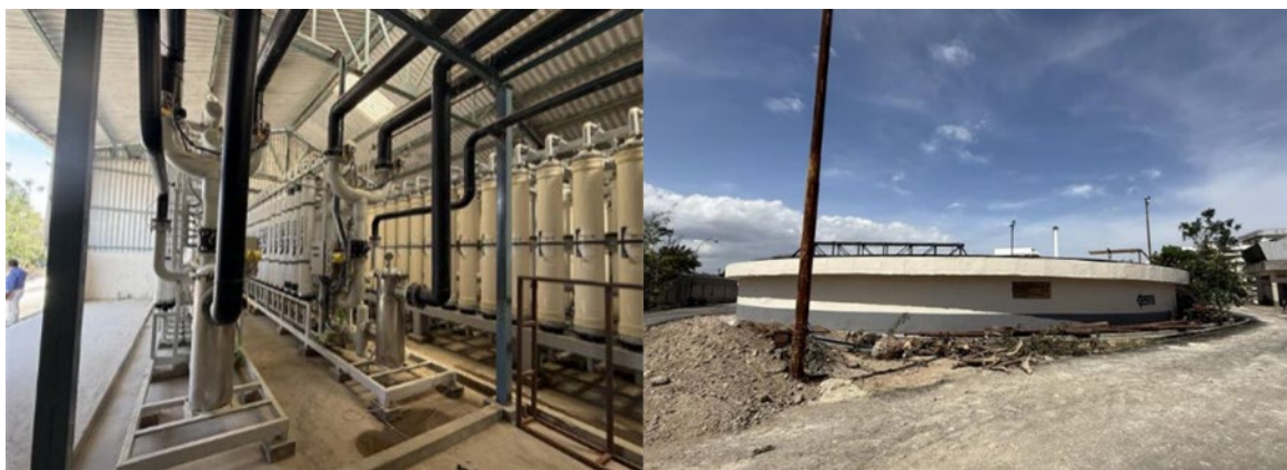
図 5-9 MURUGAMPALAYAM CETP の設備
