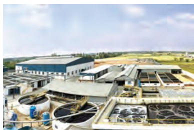
▲ALTAS社の排水処理設備
