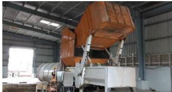
中継施設の積み替え設備
