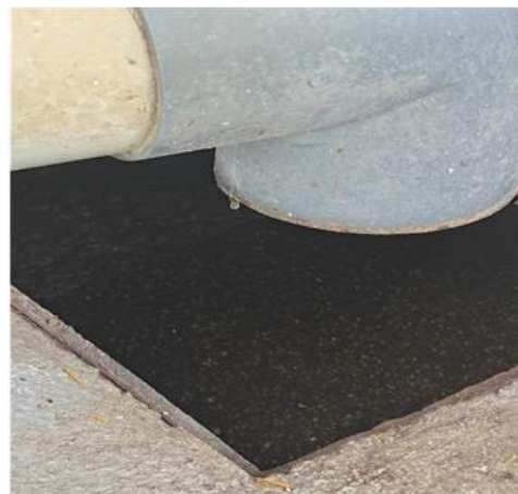
消化汚泥の排出先
