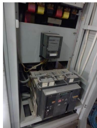
写真 46 空冷チラー用 分電盤内ブレーカ
