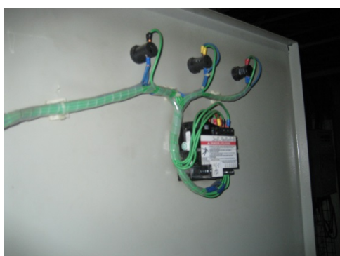
写真 4 CT 設置後 (チラー)
