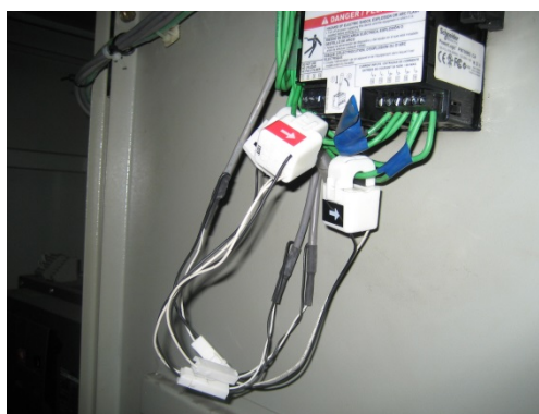
写真 4 CT 設置後 (チラー)
