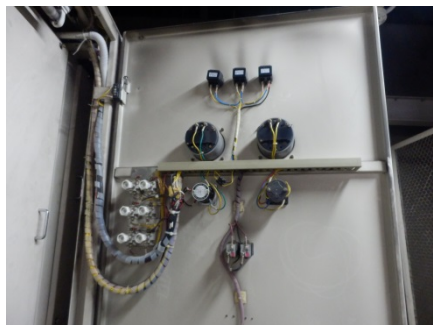
写真 47 変圧器No.2 系統計器類裏面
