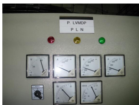
写真 14 低圧主配電盤外部 (地下 2 階 B 系)
