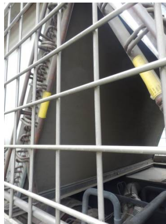
写真 53 空冷チラー 熱交換フィン
