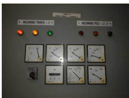
写真 37 変圧器No.3 分電盤
