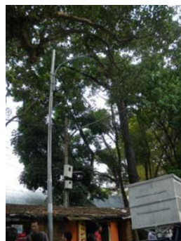
写真 5 LED 街路灯 (全景)
