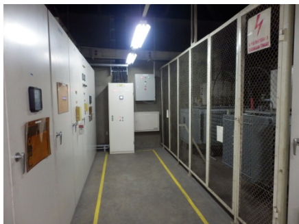
写真 48 33号建物用変電室内観
