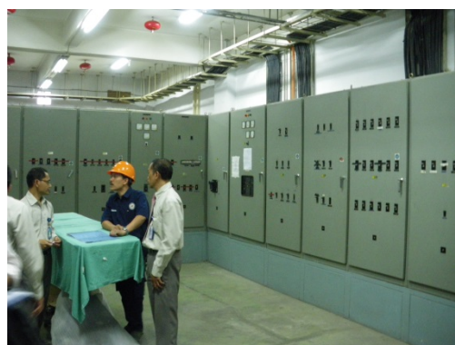
写真 11 受変電室（YOSEF 棟）
