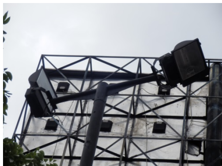
写真 28 建物正面の街灯
