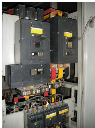
写真 13 低圧主配電盤内部 (A 系)
