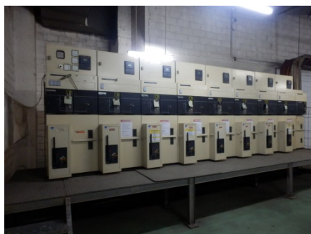
写真 32 モール施設の受電部分
