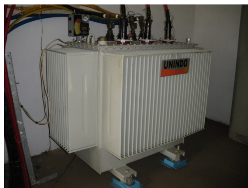
写真 9 受電トランス（630kVA）
