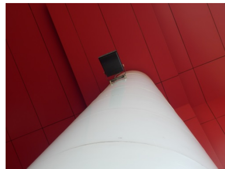
写真 57 エントランス底部 ライトアップ用照明
