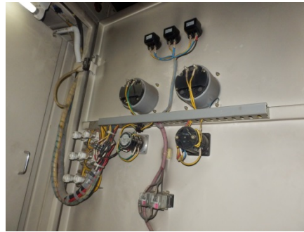
写真 45 変圧器No.1 系統計器類裏面
