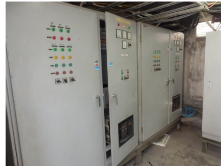
写真 4 空冷チラー用分電盤 (モール 2 系)
