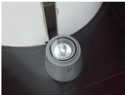
写真 56 エントランス柱部 ライトアップ用照明
