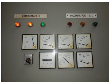
写真 34 変圧器No.1 分電盤
