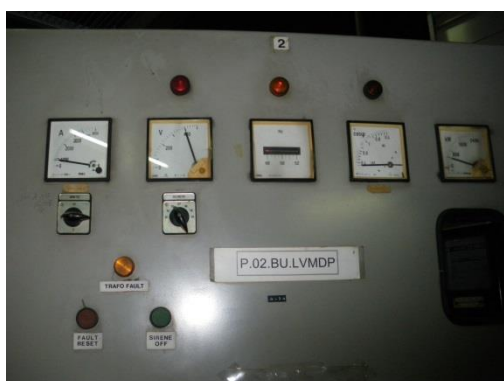
写真 12 低圧主配電盤外部 (A 系)
