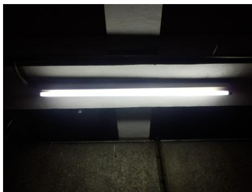
写真 16 駐車場照明 (1 灯用)
