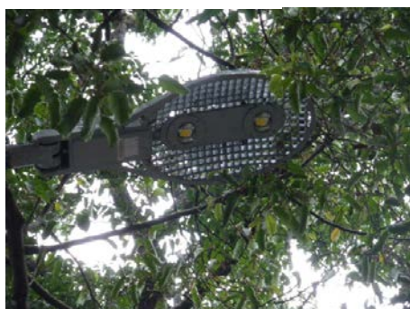
写真 4 LED 街路灯 (照明部)
