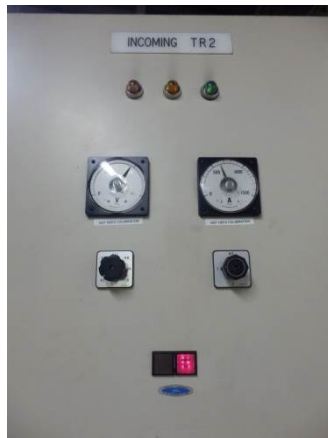
写真 46 変圧器No.2 系統計器類
