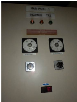
写真 44 変圧器No.1 系統計器類
