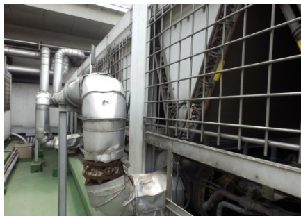
写真 51 空冷チラー用配管
