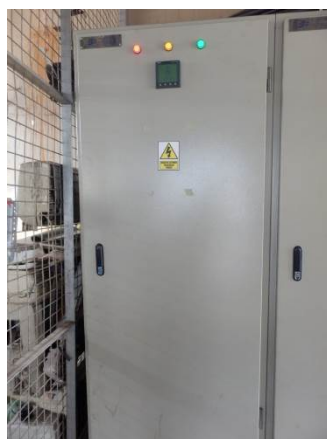
写真 40 水冷チラー用分電盤
