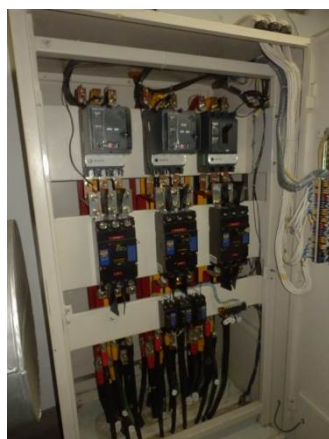
写真 55 空冷チラー用分電盤
