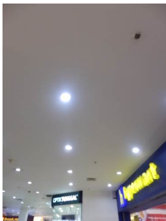
写真 20 店内通路照明 (コンパクト蛍光灯タイプ)
