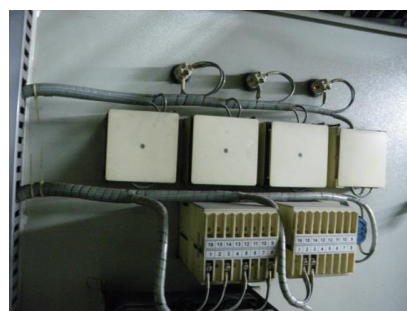
写真 15 低圧主配電盤扉裏面 (地下 2 階 B 系)
