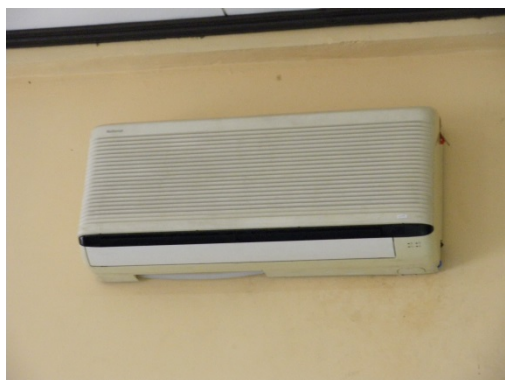
写真 8 個別パッケージ空調機（壁掛け）
