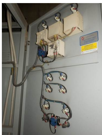
写真 47 空冷チラー用 分電盤裏メーター配線
