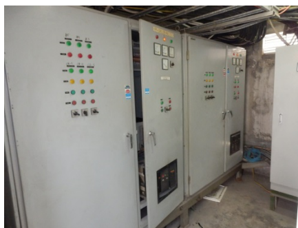
写真 45 空冷チラー用 分電盤（モール 2 系）
