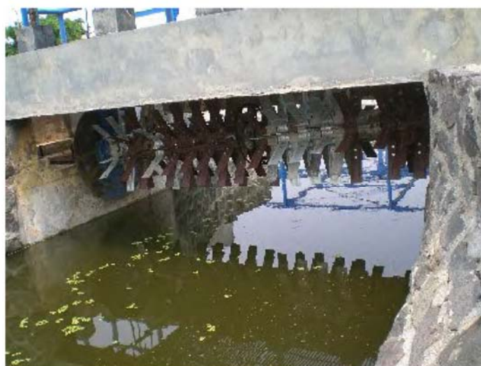
写真 4.2 (22) マンモスローター
