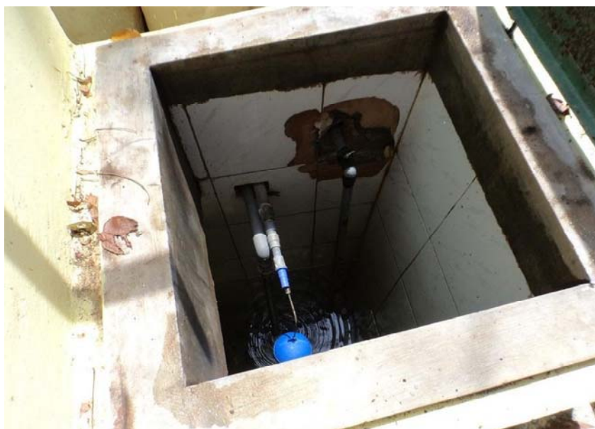
写真 3.1 (1) 住居受水槽状況
