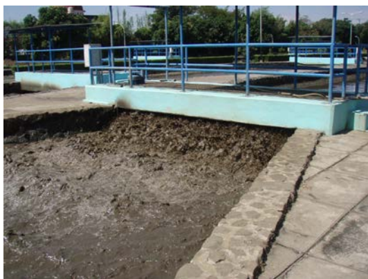
写真 4.1 (12) 廃水処理施設の エアレーション装置
