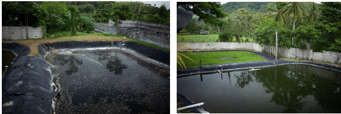
図 3-19 PT. Trijaya Tangguh の排水処理設備の様子 (2024年6月)
