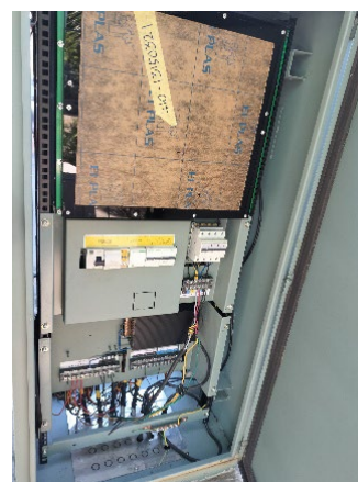
マカッサル市のITCSの信号制御機内部
