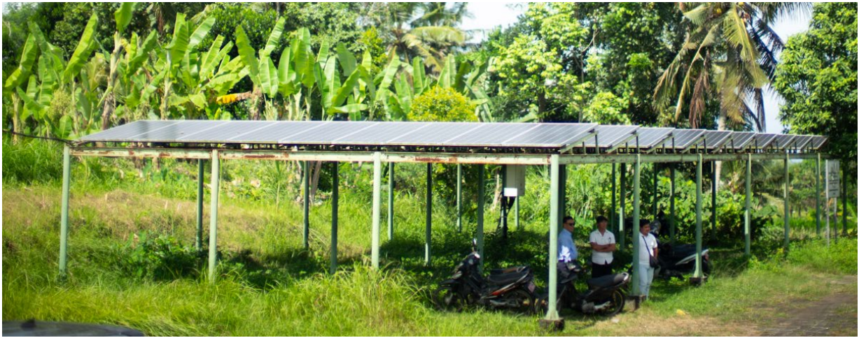
図 3-40 残存する太陽光発電設備
