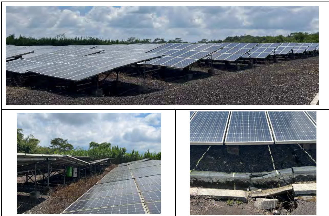
図 3-1 バンリ県メガソーラー発電所現況
