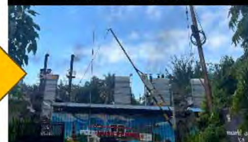
Nusa Penida島発電所
