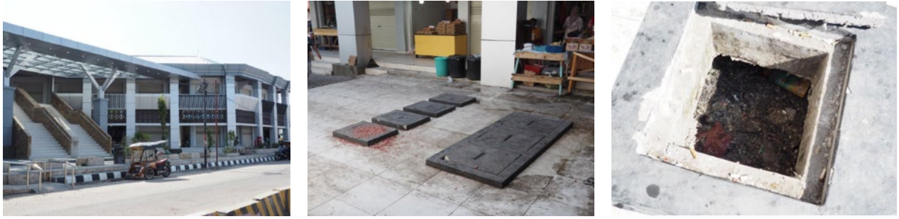
図 3-18 ゴロンタロ市市営中央市場（Pasar Sentral Kota Gorontalo）の排水処理設備
