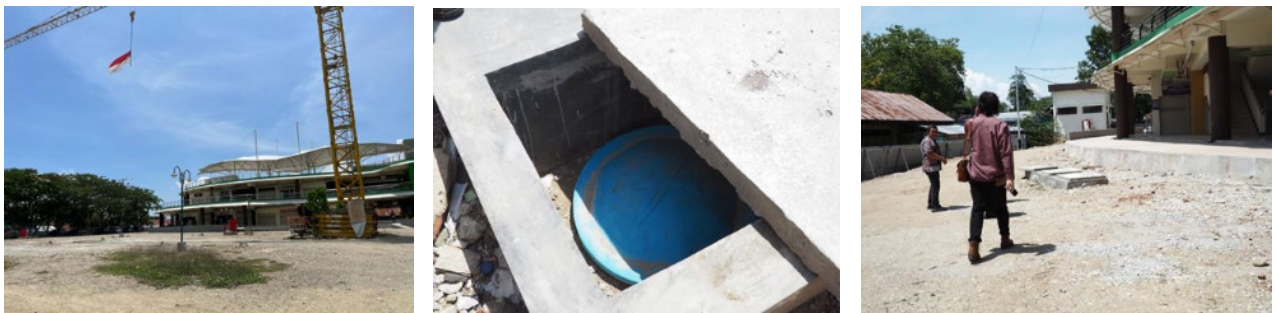
図 3-19 ゴロンタロ県県営中央市場（Pasar Modern Limboto）の排水処理設備
