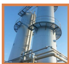
愛研化工機による メタン発酵設備の横展開
