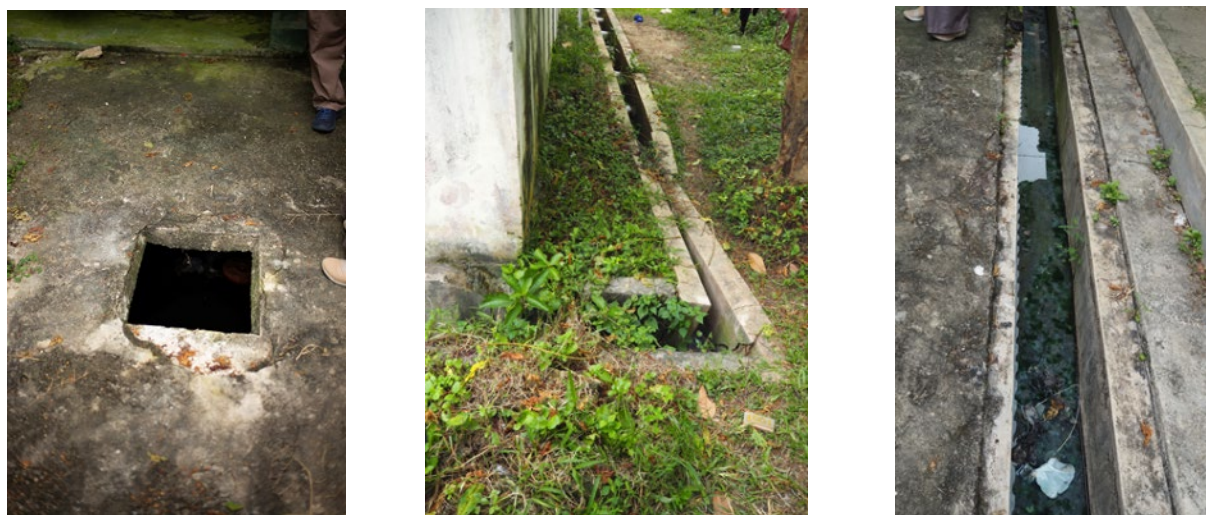
図 3-14 女子寮における排水処理（し尿処理（Septic Tank）（左）と生活排水路（右））
