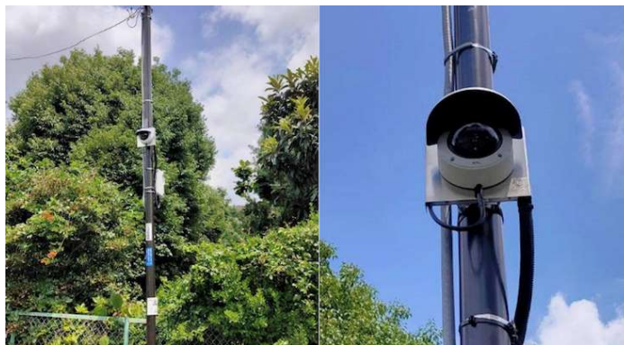
図 4-8 杉並区に設置された IoT 道路灯システム
