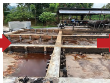
排水処理場（油水分離槽） ※浮上油は人力で採取
