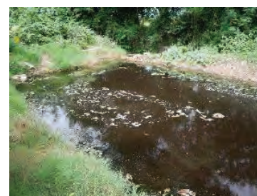
本来ため池の底のフィルターでろ過し地面に浸透させていたが、現在はフィルターが詰まり、河川へ放流されている状態
