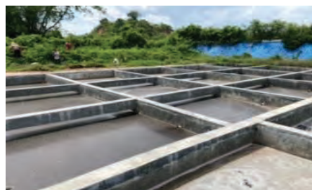
排水処理場（好気処理？）
