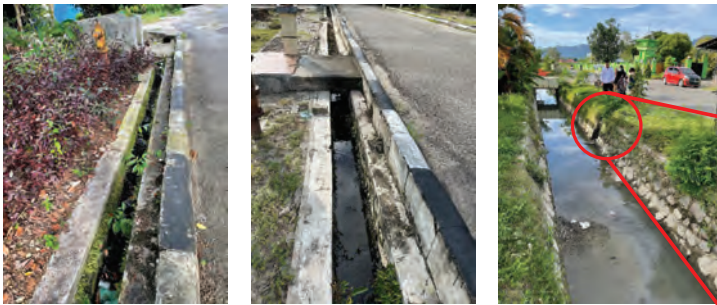
▲建物脇にある排水路で排水を集め、校外の排水路へ
