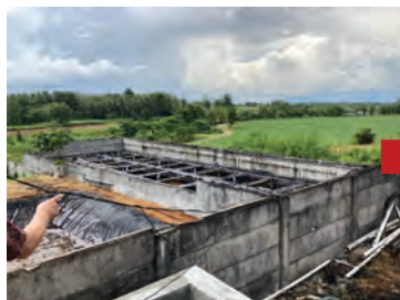
排水処理場（好気処理？）
