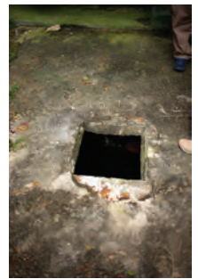
▼地下のし尿処理設備
