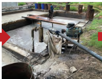
排水処理場（沈殿槽） ※ポンプにて植物処理槽へ
