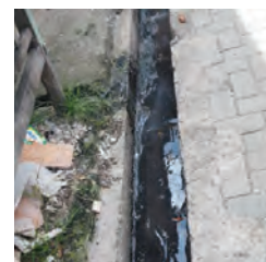
▲市場の排水路
