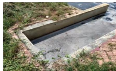
排水処理場（浸出水流入口）
