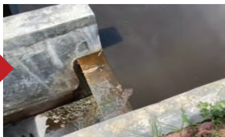
排水処理場（処理水出口）
