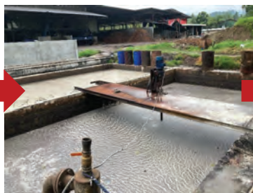
排水処理場（沈殿槽） ※水面には油が浮上
