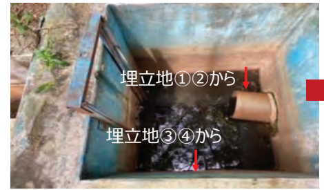
排水処理場（浸出水流入口）
