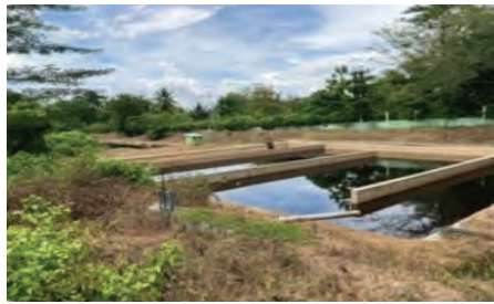
排水処理場（全体）
