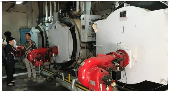
ホテルのボイラ等設備調査(2019年11月)
