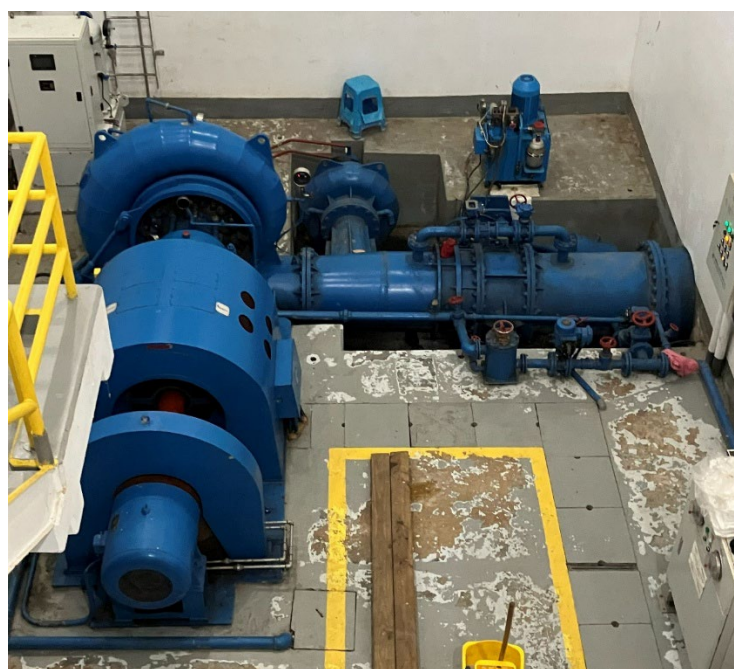
図 2-8 タービン・発電機
