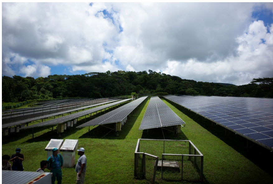
図 2-13 Pohnlangas 地点における既設太陽光発電設備
