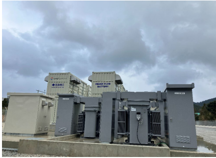
変電所・大型蓄電池
