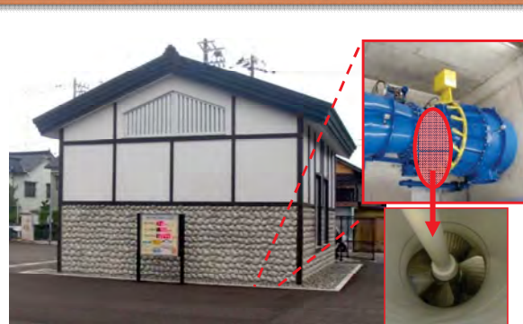
東町・東新町公民館小水力発電所
