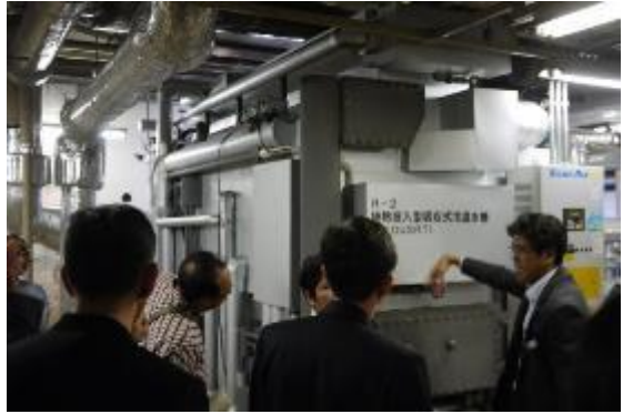
排熱利用に関する設備
