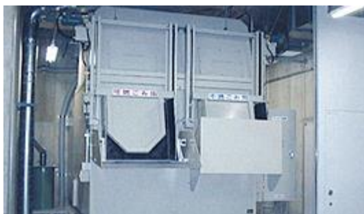
図 2-6 有機系廃棄物を一時貯留する減容固化設備
