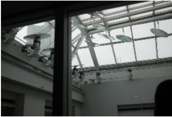
エコボイド・自然光採光設備
