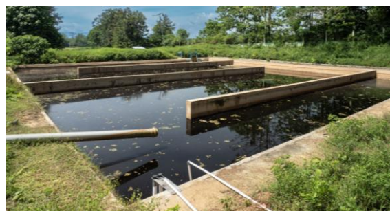
既存の最終処分場浸出水処理設備
