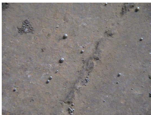
化学工場内の床に凝結している水銀
