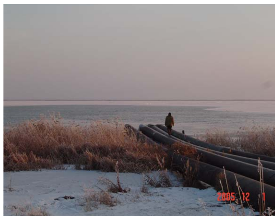
アスタナ郊外の下水処理水排出場所 （処理水は貯水池に放流される）
