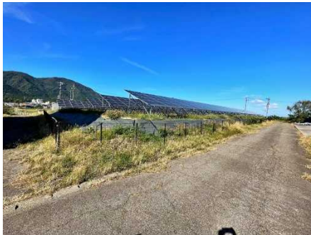
太陽光発電設備
