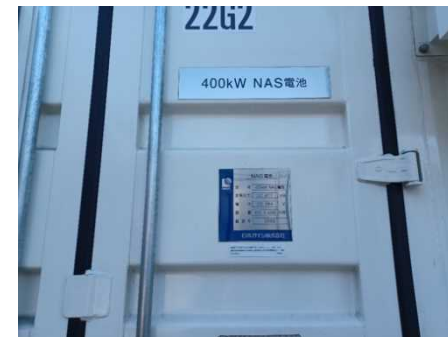
定置用蓄電池
