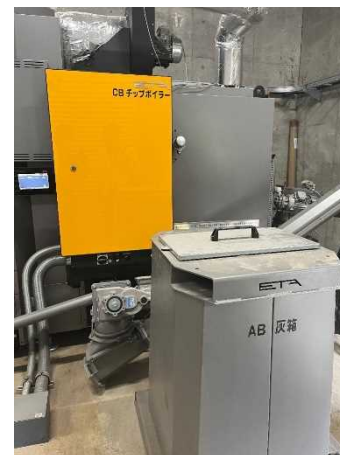
チップボイラー
