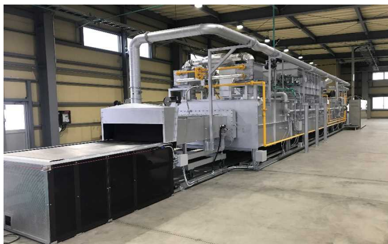
熱分解処理炉
