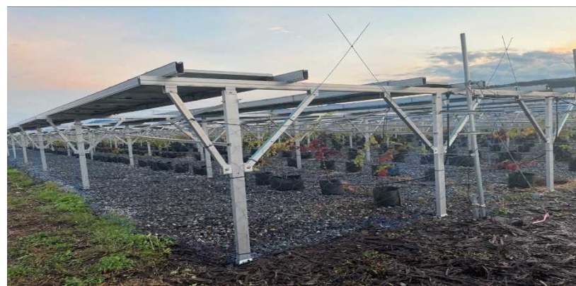
太陽光発電設備
