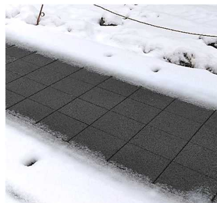
設備の敷設箇所
