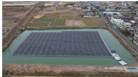
太陽光パネル（フロート式架台に設置）
