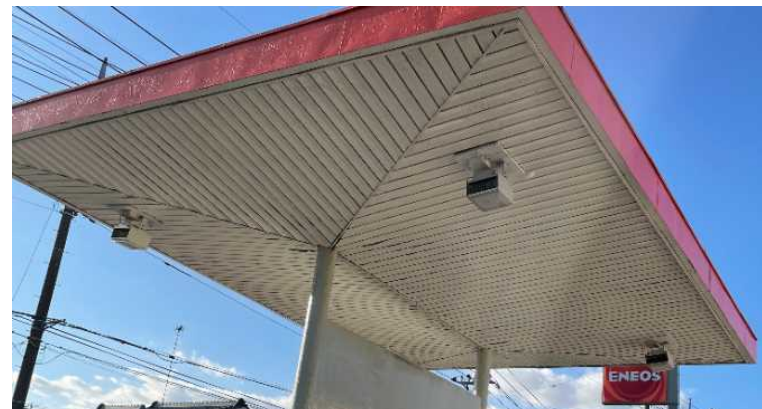
LED照明設備
