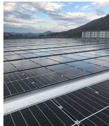
太陽光パネル
