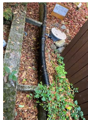
温泉供給配管
