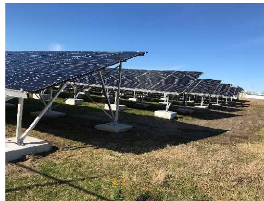
太陽光パネル
