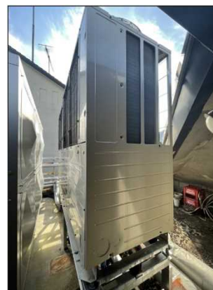
ヒートポンプ給湯器
