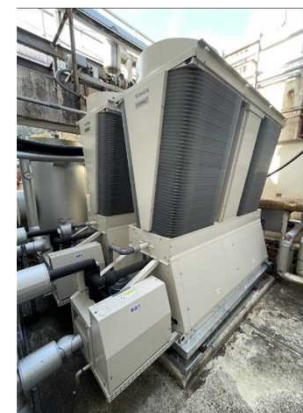
高温水ヒートポンプ
