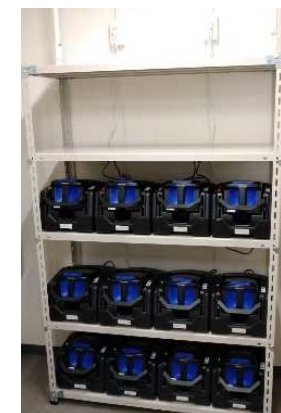
バッテリーステーション
