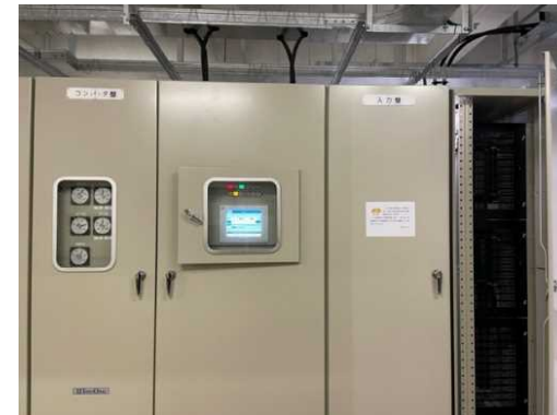
回生電力貯蔵装置②
