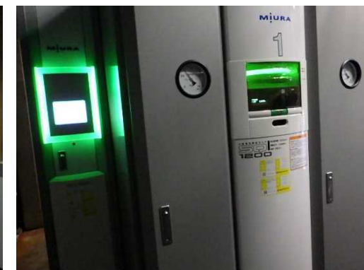
低圧ボイラー
