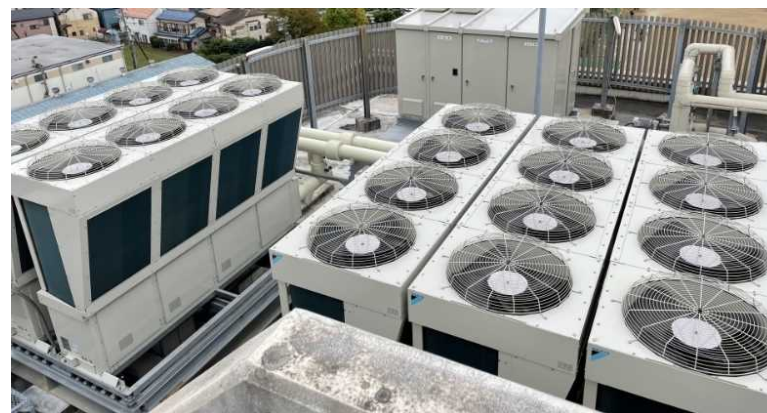
ヒートポンプチラー
