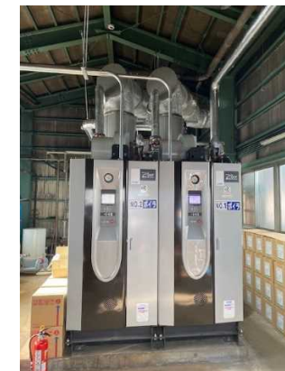
ガス焚き貫流ボイラ
