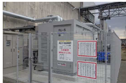
アンモニア冷媒冷凍冷蔵機
