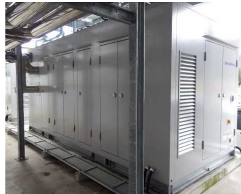
冷凍パスタライン：NH 3 /CO 2 冷凍機
