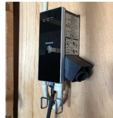
EV車用充電器
