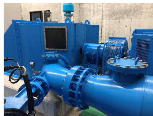
水車内蔵設備
