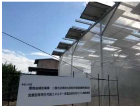
太陽光パネル
