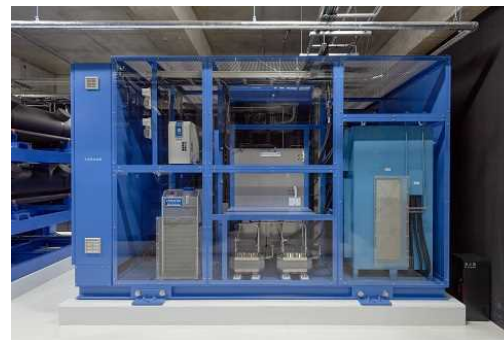
水素製造設備
