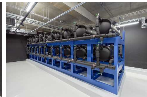
水素貯蔵設備
